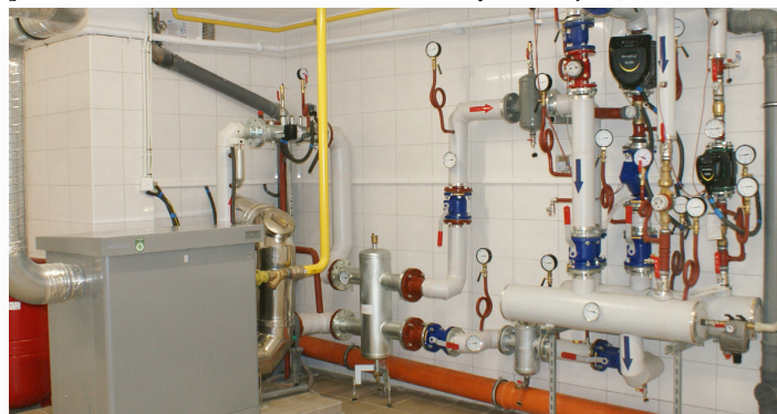
➤ Kotłownia gazowa Szkoły Podstawowej w Rudkach
